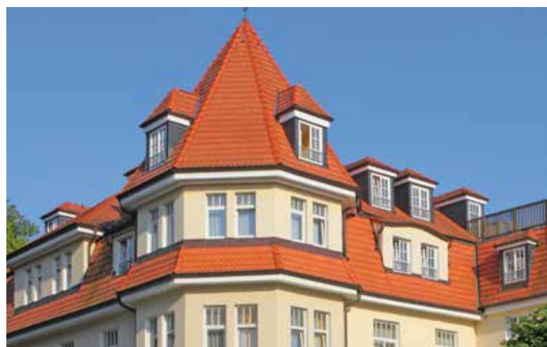
Unten: Die Gauben in der zweiten Dachebene sind zu dominant, denn die Firstlinie ist nicht mehr durchgehend zu erkennen, dadurch wirkt das Dach nach oben ausgefranst. Auf ein solch kleines Turmdach gehören keine Gauben, hier müssen andere Belichtungsmöglichkeiten gefunden werden.
