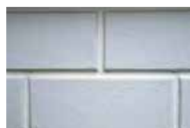
Putzbänderung ist verbreitet an Sockelgeschossen.
