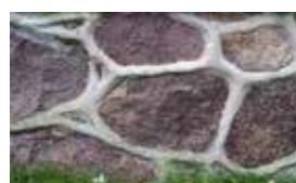
Natursteinsockel – Auch hier ist der Erhalt gewährleistet, soll aber bei Neu- und Erweiterungsbauten keine Nachahmung finden.
